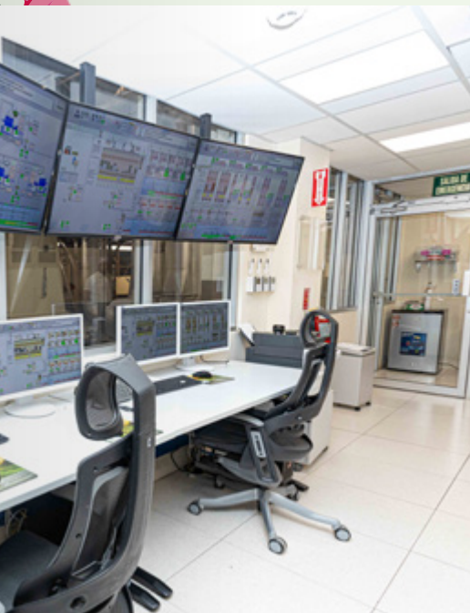
PILOT PLANT Control System: Die komplette Kaffeeverarbeitungsanlage am INDUBAN-Standort in Santo Domingo ist in die vollautomatische PILOT PLANT-Steuerungslösung integriert, die höchste Sicherheitsstandards garantiert
